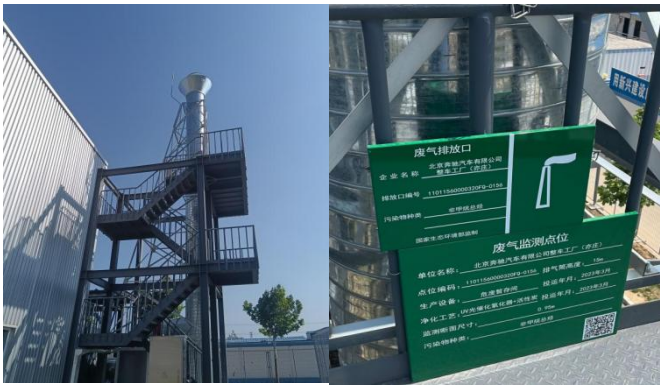
图 2-11 危废库新增的排气筒
