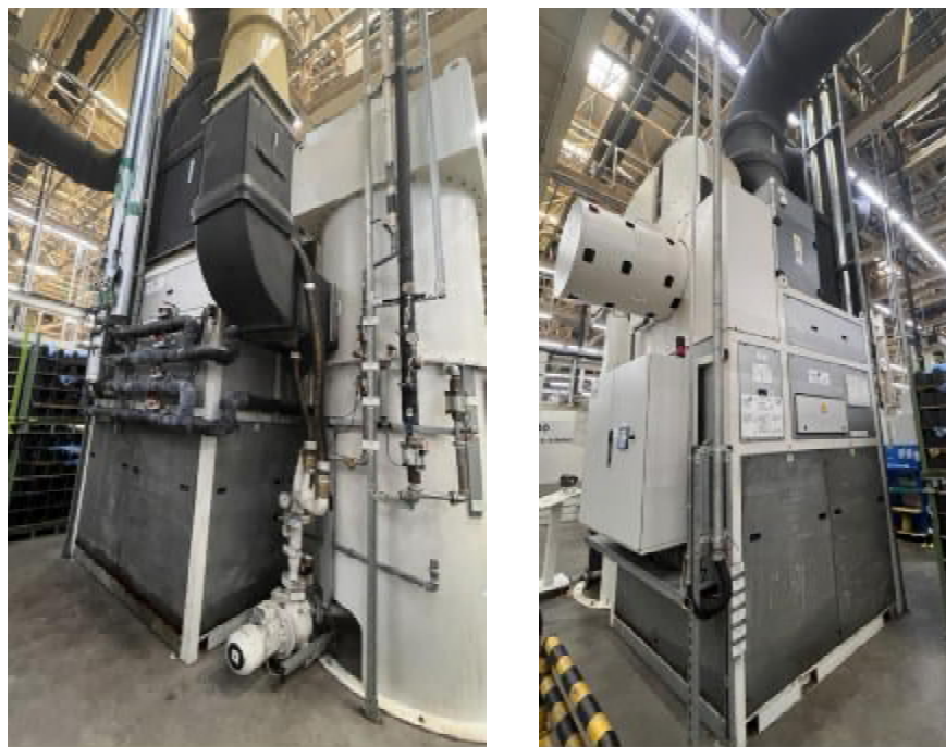
图 3.2-1 文丘里湿式除尘器+旋风除尘器+油雾分离器照片
