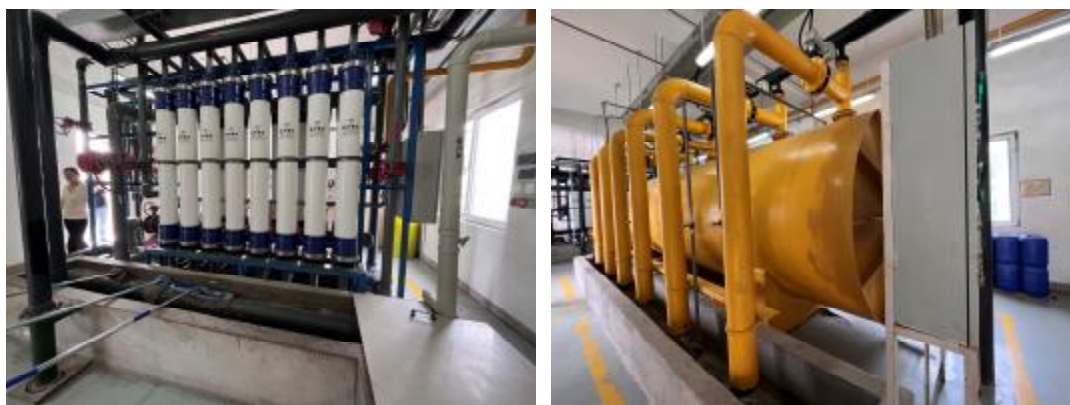
图 3.2-4 厂区污水处理设施照片
