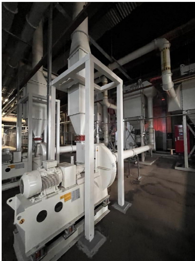
图 3.2-3 干式滤筒除尘器照片
